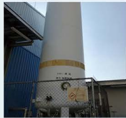
■ 液態氮氣儲存槽
